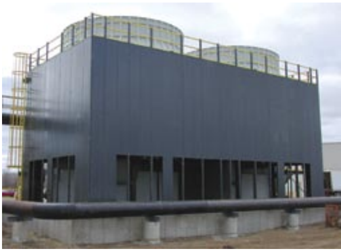
コンポライトを使用したクーリングタワー： 耐腐食性、耐候性、低メンテナンスコスト。
